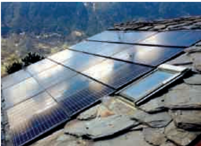
Esempio di pannelli fotovoltaici semplicemente integrati nel manto di copertura, ma decontestualizzati.
