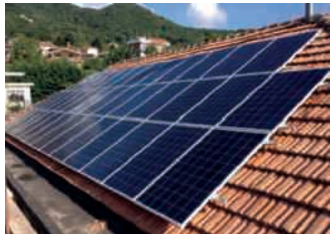
Esempio di pannelli fotovoltaici appoggiati, complanari alla falda, ma decontestualizzati
